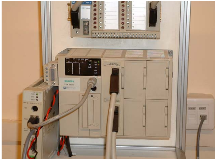
Fig 8.- PLC instalado en la Escuela.
